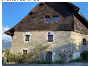
Végétation en pied de mur - Charvonnex
